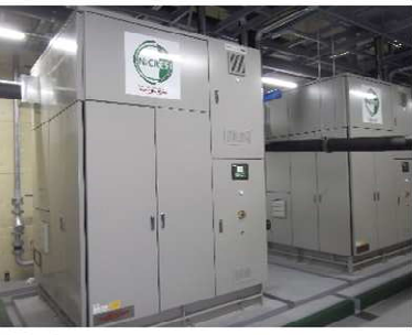
「NiCREs」の機械室設置例
