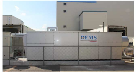
陽圧除湿空調システム
